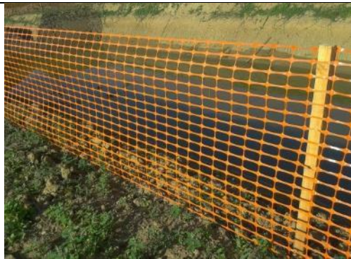
Exemple de filet de chantier matérialisant physiquement la limite du projet à ne pas franchir pas le personnel et les engins (© SAMEX)
